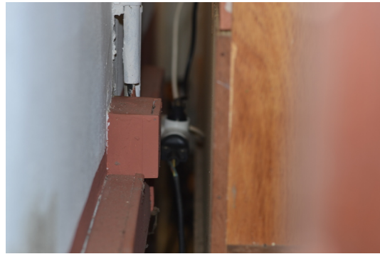
branchements électriques derrière un plan de travail (avec multiprise)
