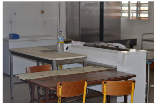
Mobilier en bois difficile à entretenir (partie cuisine, bois abîmé et vernis écaillé, plastique adhésif arraché) et calandre de repassage au milieu
