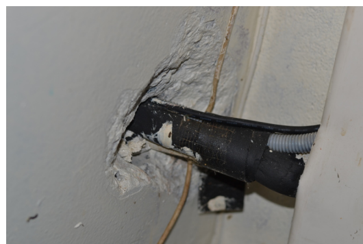
trou dans le mur pour la sortie de clim (bas du mur)
