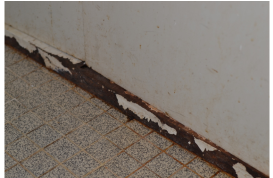
Rouille en bas d'un placard métallique
