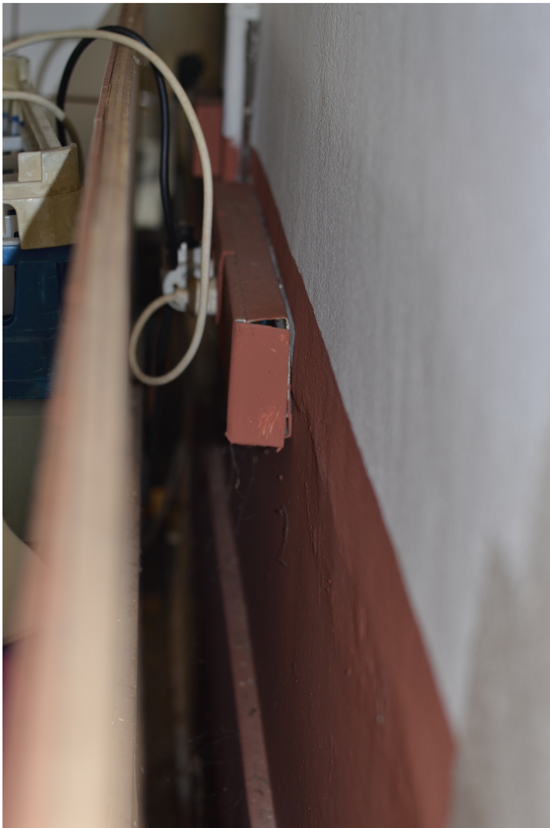
branchements électriques derrière un plan de travail (avec multiprise)
