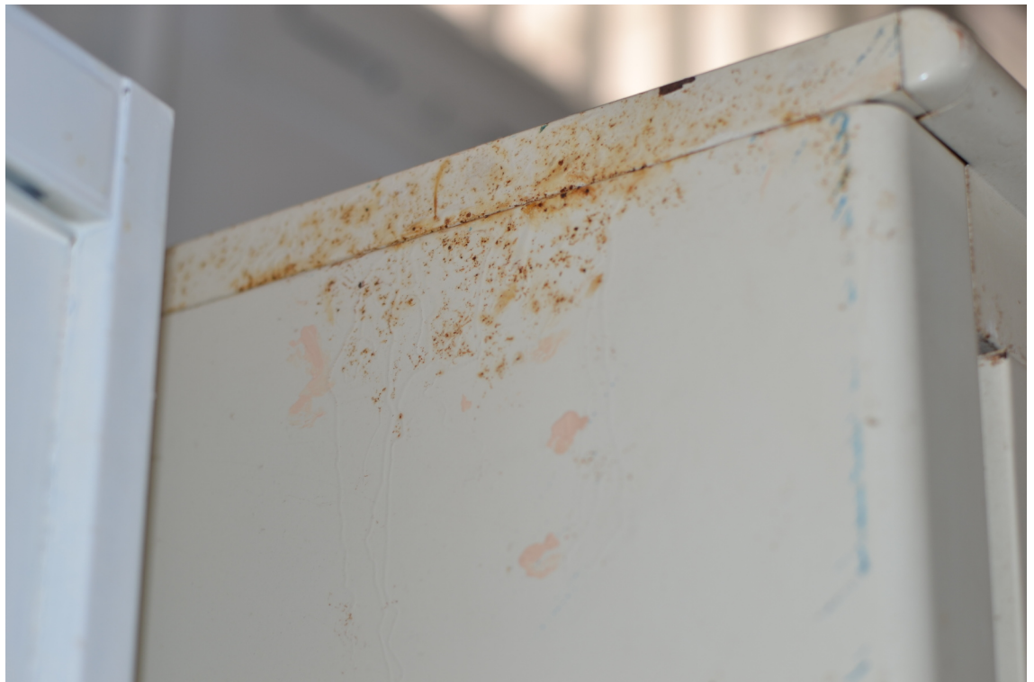
Rouille en haut d'une armoire métallique
