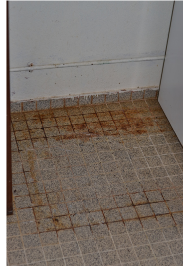
Sol encrassé sous la monobrosse (ce n'est pas de la rouille)
