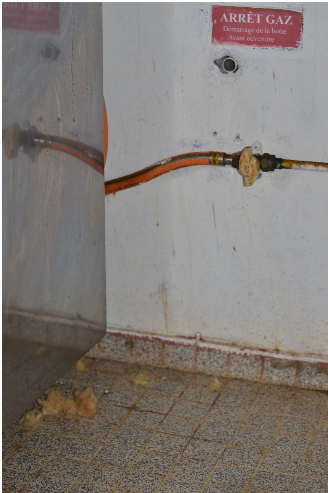
Isolation thermique du piano de cuisson qui se répand au sol.
